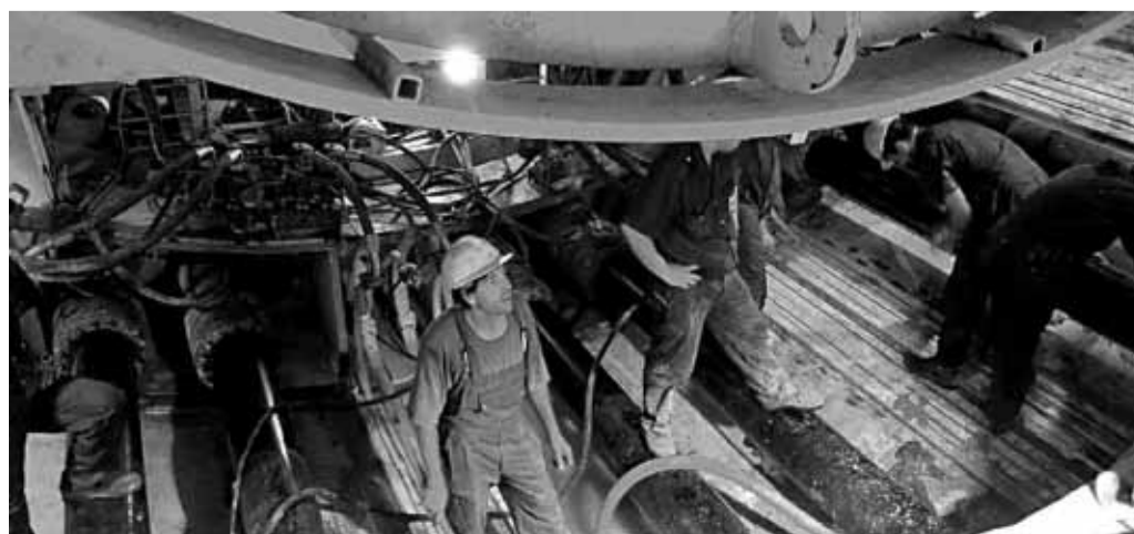
Aspecto de la excavación de la línea en el ramal de Santa Coloma, en Can Zam
